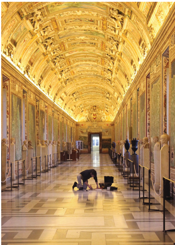
Fig. 5 Réparation du sol en marbre à l'intérieur de la galerie de Cartes. (© Governatorato SCV – Direzione dei Musei)
